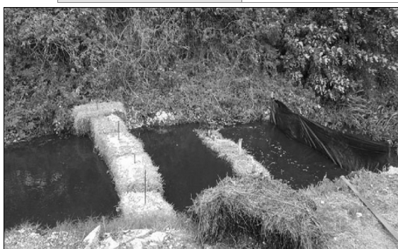
Exemple de barrière à sédiments à ballots de paille suivie d'une barrière à géotextile.
