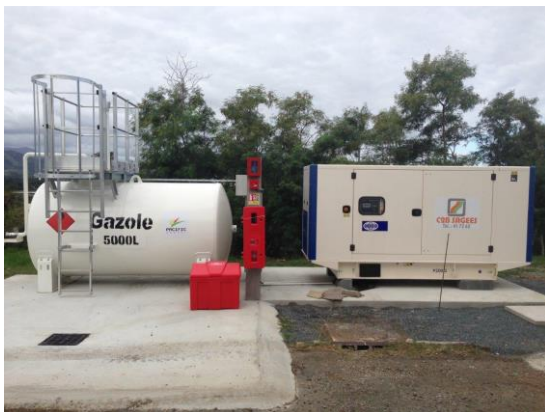
Figure 9 : Groupe électrogène et cuve de gazole.
