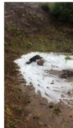
Fuite après pose des roches
