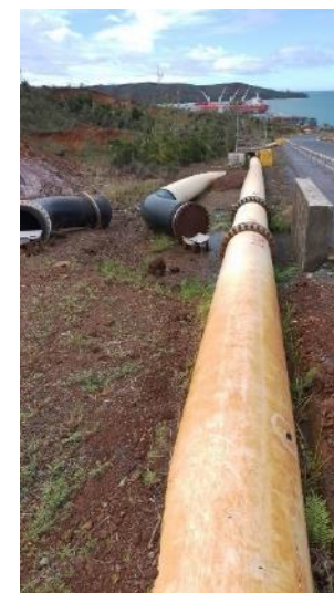
Bride pleine amont chambre des vannes
