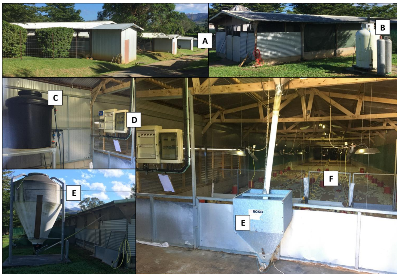
Figure 5 : Poulailers : A) Extérieur des bâtiments ; B) Bombonne de gaz ; C) Cuve ; D) Compteur électrique ; E) Silo individuel de capacité 3,6 tonnes et début rampe d'alimentation ; F) intérieur poulailler.
