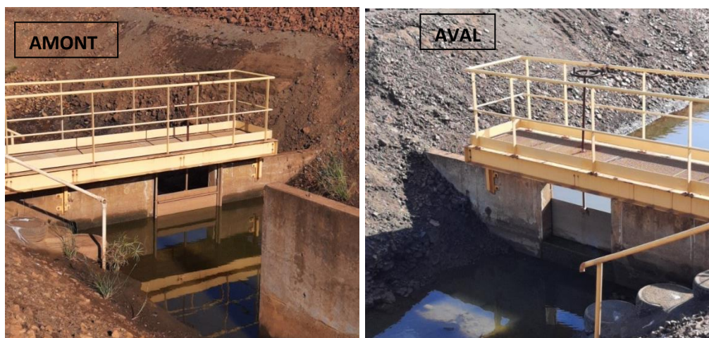
Figure 3: Photographie de la vanne guillotine du point de rejet E4, point où est mesuré le niveau permettant de calculer le débit.
