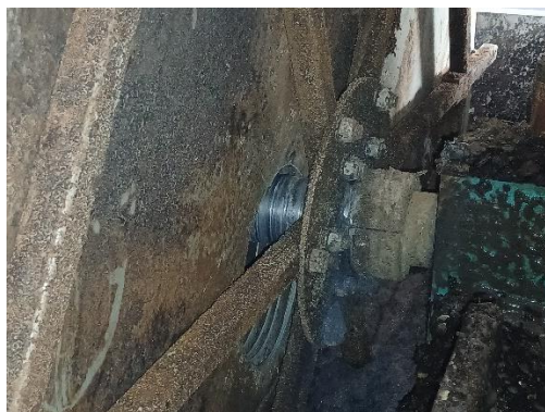
Dommage Serrage Axe
