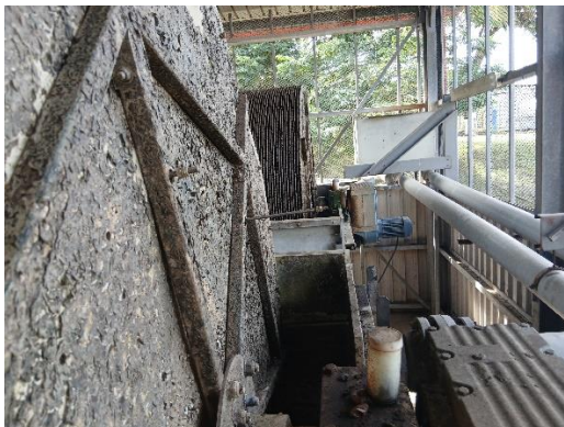
Rupture serrage disques
