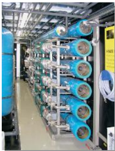
Figure 10 : Vue osmose inverse
