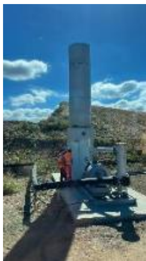
Figure 9 : Vue de la torchère
