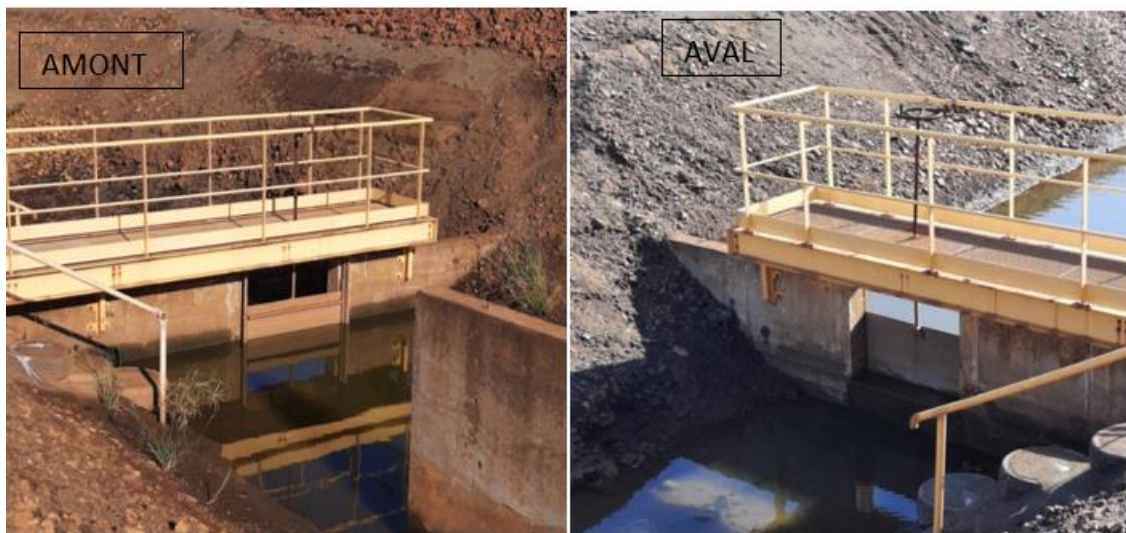
Figure 44: Photographie de la vanne guillotine du point de rejet E4, point où est mesuré le niveau permettant de calculer le débit.
