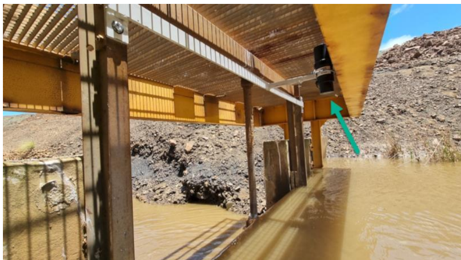
Figure 45 : Photographie de la sonde de niveau (à ultrasons) au point de rejet E4
