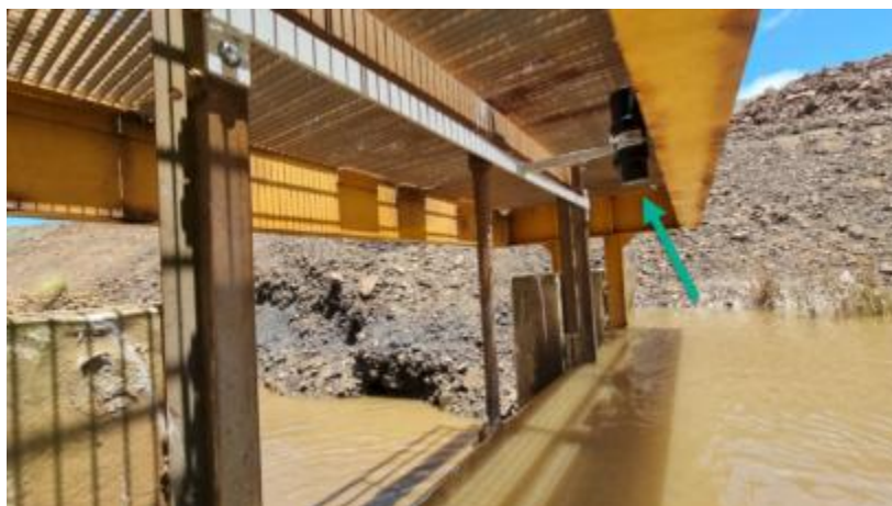
Figure 52 : Photographie de la sonde de niveau (à ultrasons) au point de rejet E4
