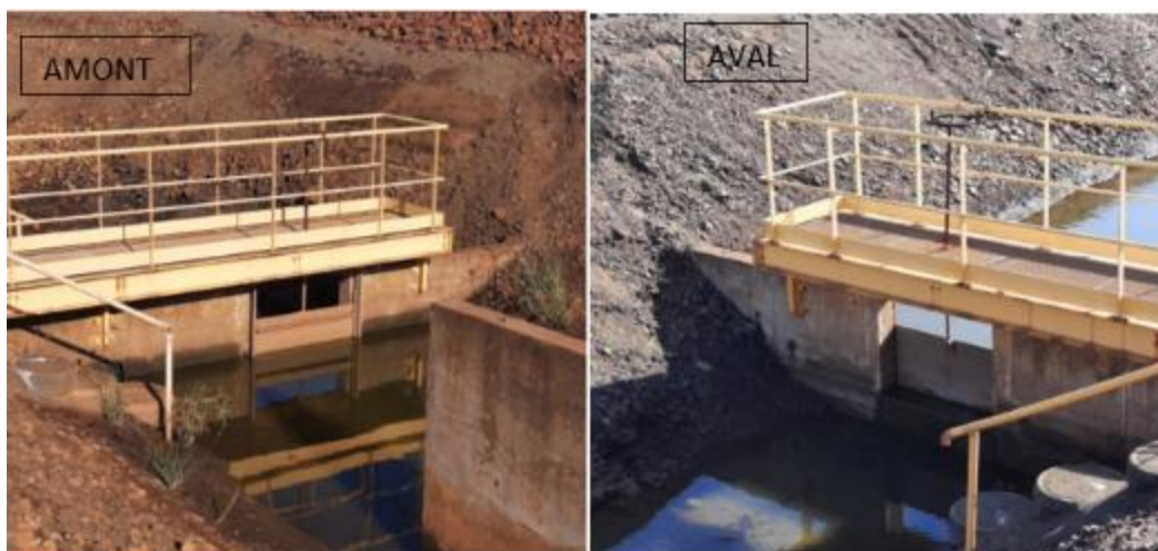
Figure 51: Photographie de la vanne guillotine du point de rejet E4, point où est mesuré le niveau permettant de calculer le débit.
