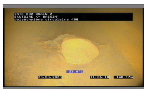
Photo: 3_3_42_A.JPG 148.53m. Dépôts de matériau grossier (gravats, gravier) sur le radier à 6 h. épaisseur des dépôts: 5 %
