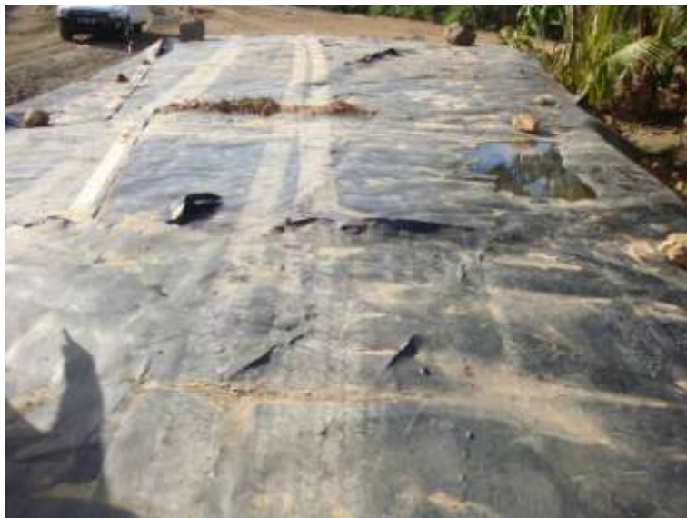
Photo 9 : géomembrane installée pour le stockage de chaux éteinte
