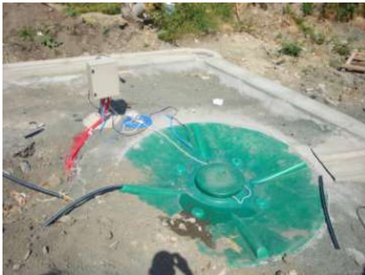
Photo 5 : zone de récupération des effluents provenant du quai des balayeuses et de la zone de séchage des boues (28 octobre 2011)
