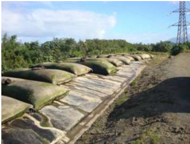
Photo 3 : zone de séchage des boues par géosacs
