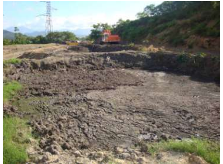
Photo 4 : bassins non étanche utilisé pour le transfert des boues
