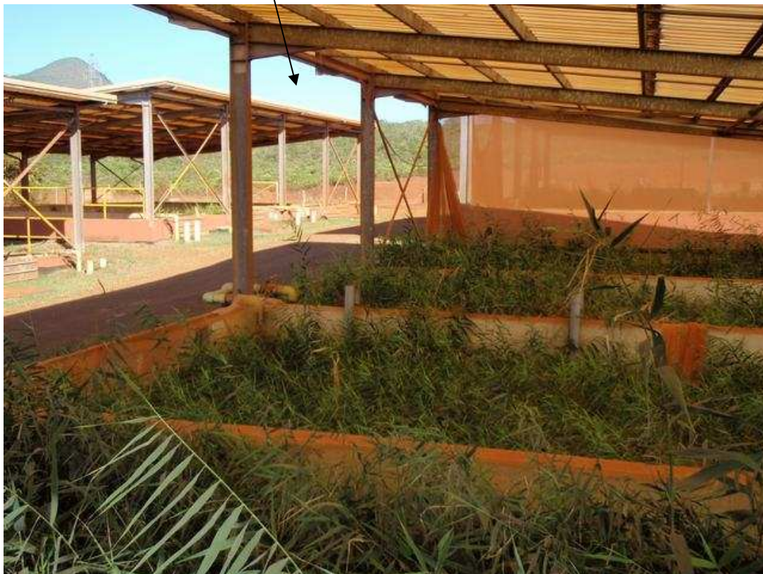
Photos 1 et 2 : Lits de traitement par rhizocompostage des boues issues de la station d'épuration de la base-vie de Vale NC – absence des filets de protection
