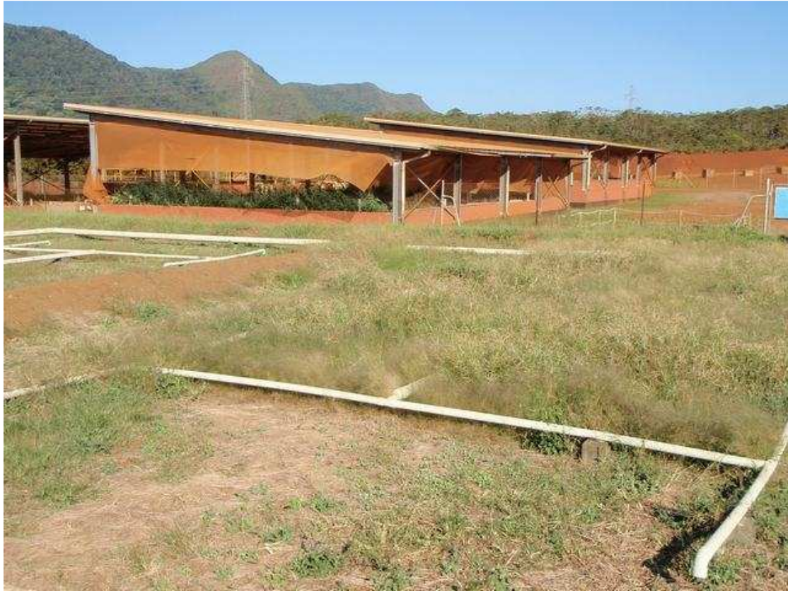
Photo 8 : Lits d'infiltration de la step5 envahis de mauvaise herbe.
