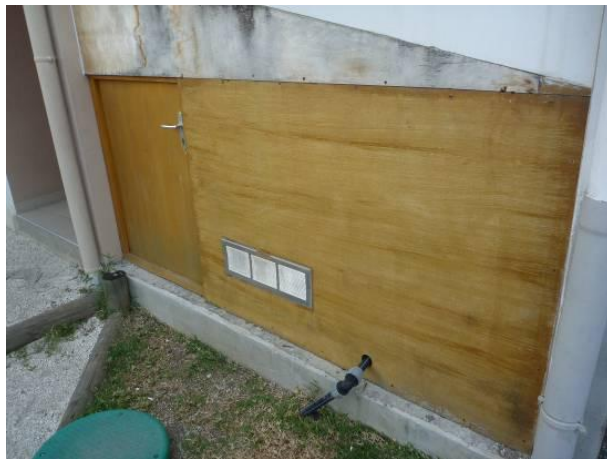
Local du compresseur
