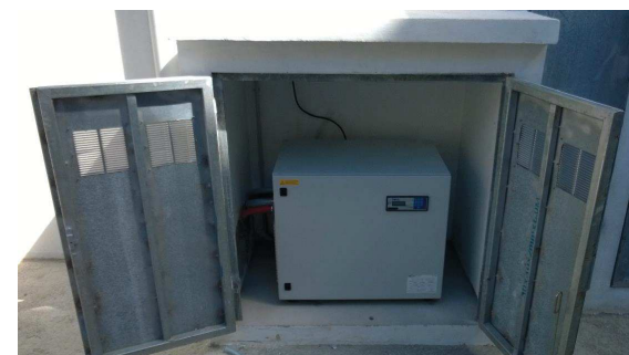
Armoire de pilotage dans son muret de protection en béton
