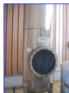
Stockage de l'eau
