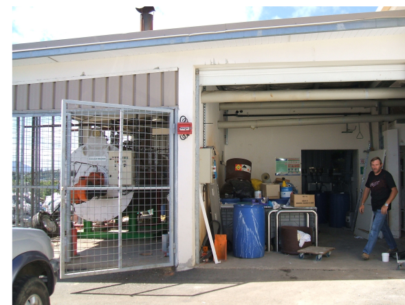
10 .Chaudière et local de produits
