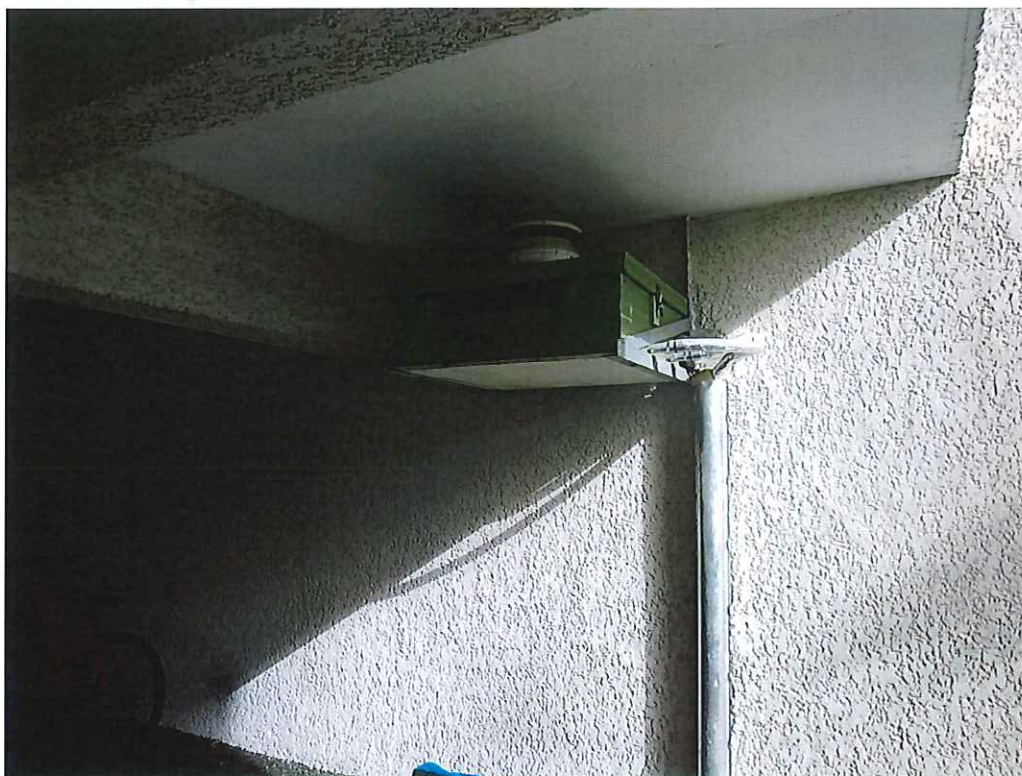
Photo 5 : Coffret technique de l'installation
