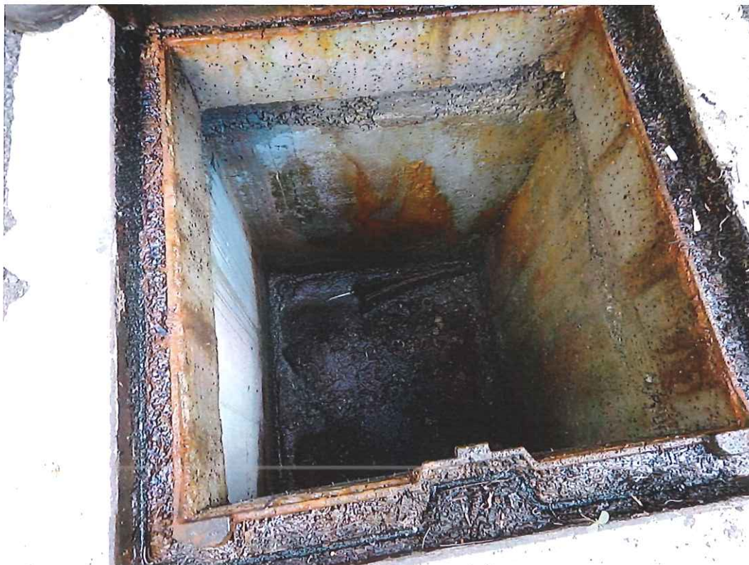
Photo 4 : Accumulation de matières dans le regard de sortie des effluents
