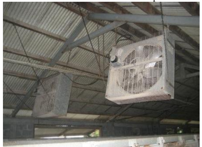
Système de ventilation
