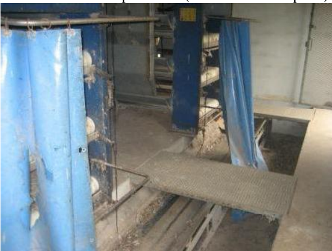
Fosses du tapis latéral d'évacuation des fientes
