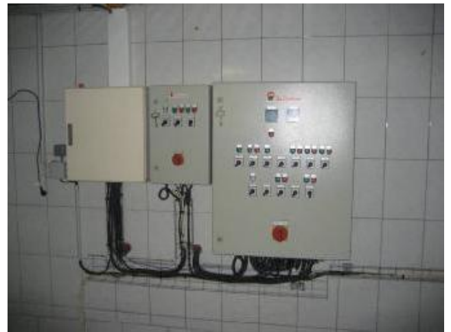
Armoire électrique – salle de conditionnement
