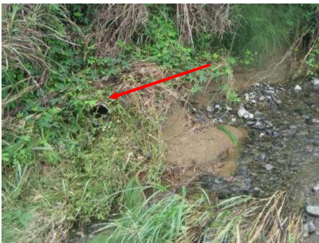
Sortie des eaux pluviales dans le creek bordant l'exploitation
