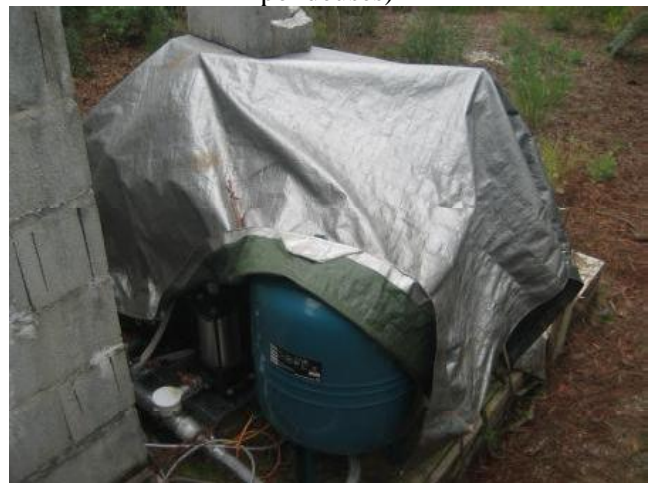
Unité de traitement de l'eau de consommation de la ferme
