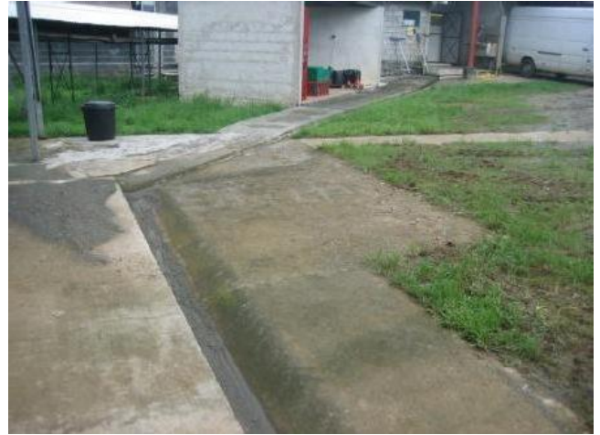
Système d'évacuation des eaux pluviales des surfaces bétonnées
