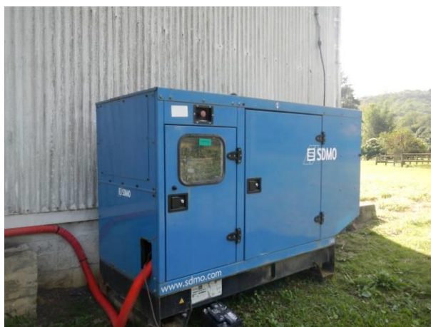
Figure 20 : Groupe électrogène 80 KVA - Photo Soproner
