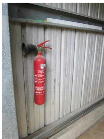
Figure 55 : Extincteur – photo Soproner
