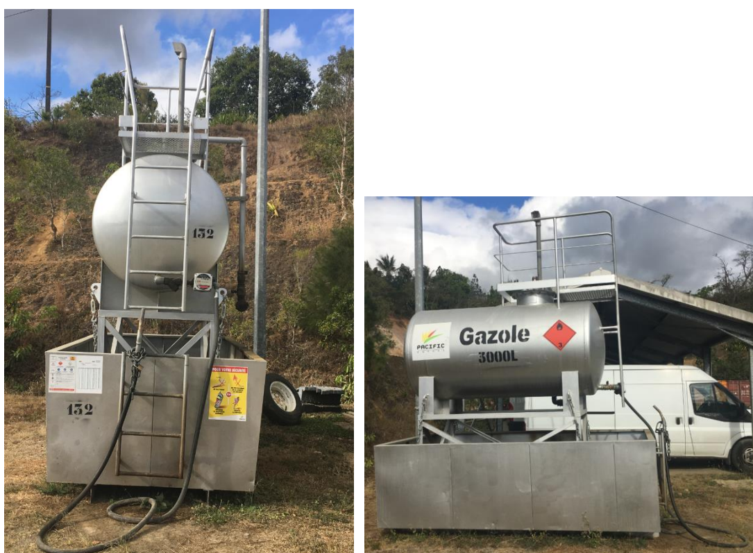
Figure 18 : Cuve à gasoil
