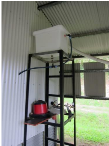
Figure 19 : Petit réservoir à flotteur – Photo Soproner
