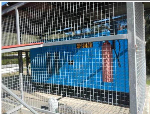
Figure 21 : Groupe électrogène 200 KVA - Photo Soproner
