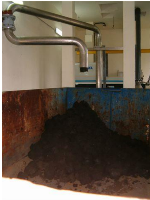
Évacuation des boues déshydratées
