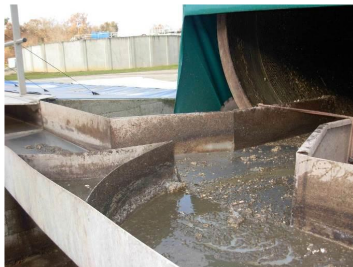
Chenaux d'alimentation du tamis dégrilleur
