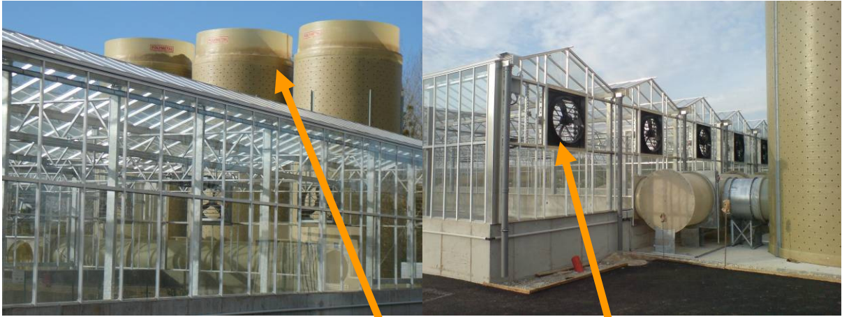
Traitement d'odeur partiel : Extraction par biofiltre ou par extracteurs muraux.
