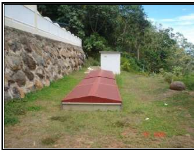
Station d'épuration à disques biologiques semi enterré
