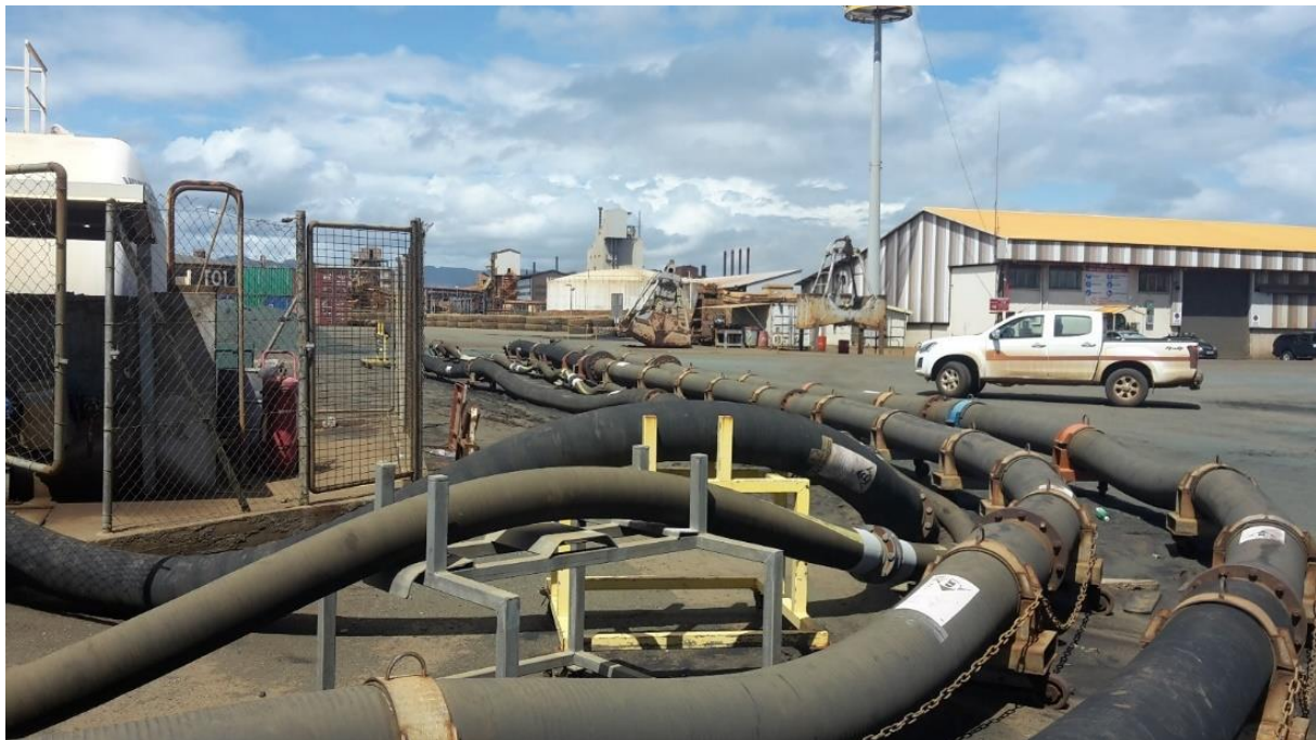
Figure 19 : Flexibles de dépotage sur le quai n°5
