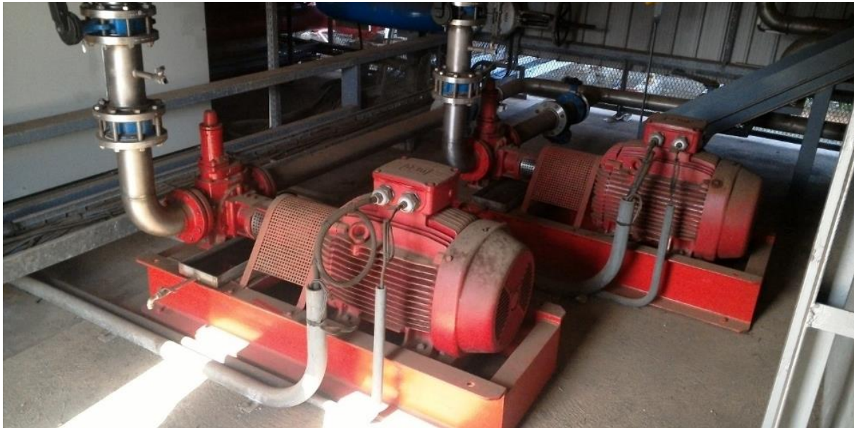
Figure 54 : Pomperie d'injection d'émulseur
