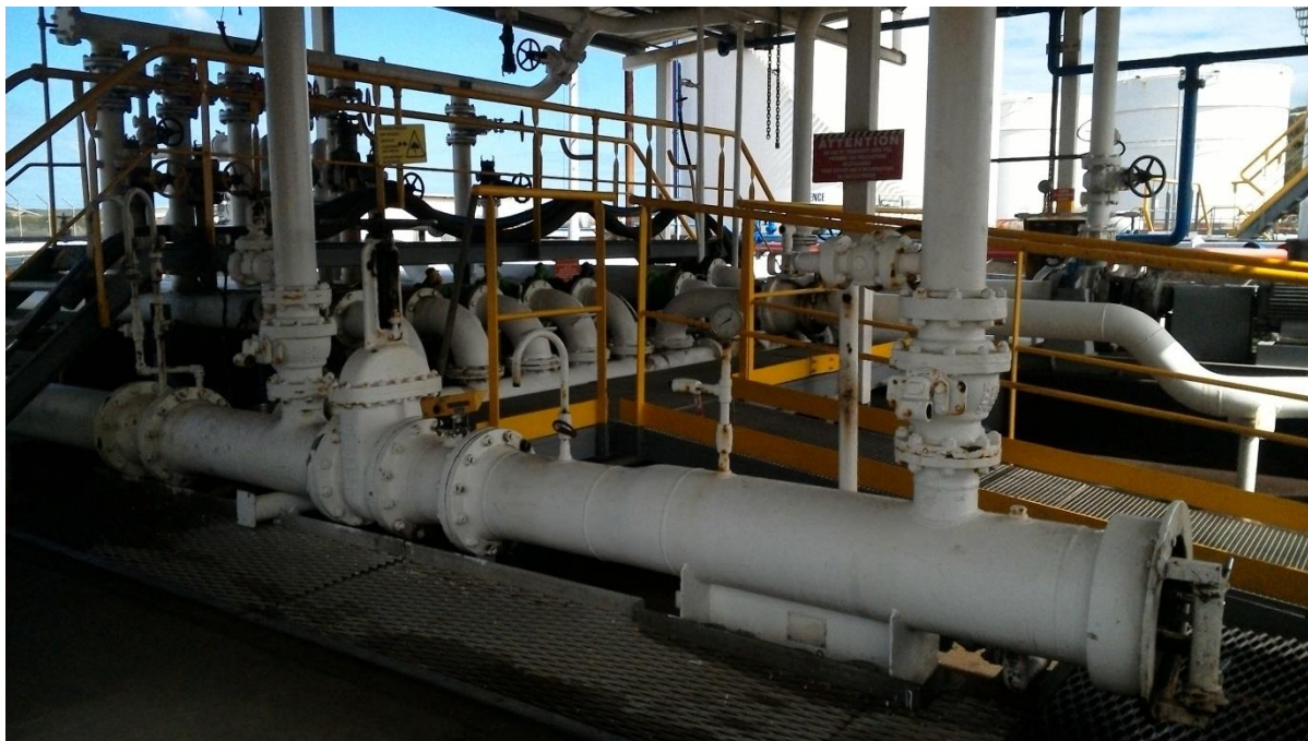
Figure 22 : Manifold du dépôt de Ducos
