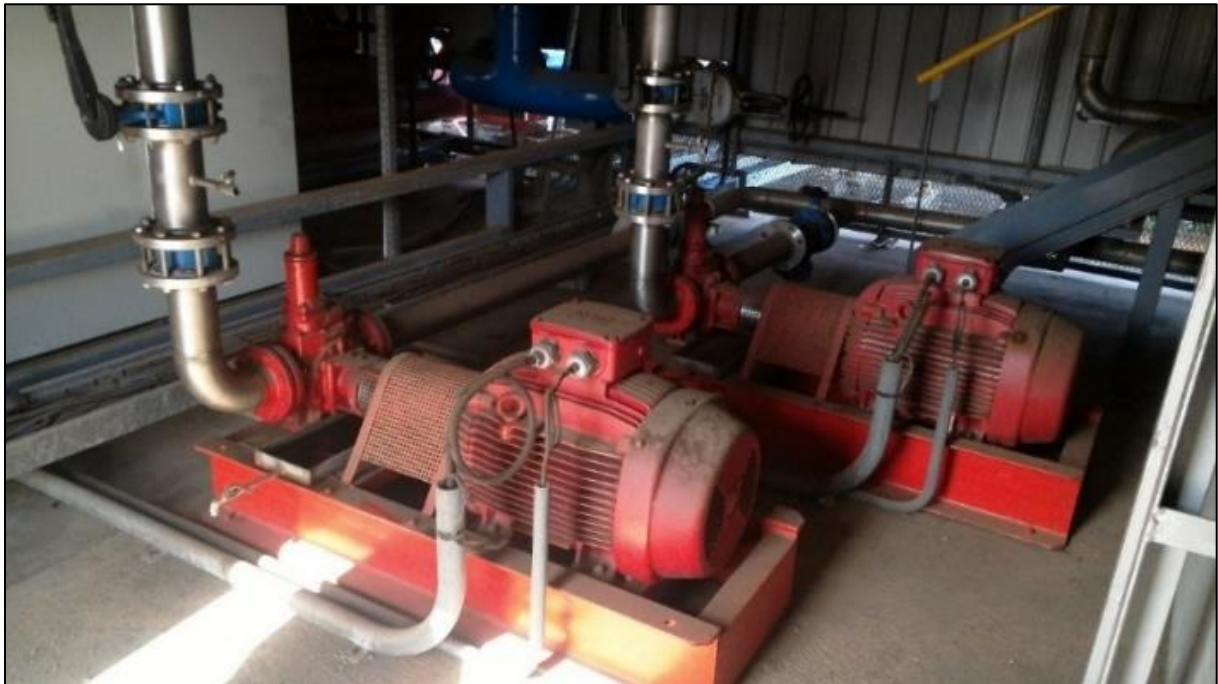
Figure 39 : Pomperie d'injection d'émulseur
