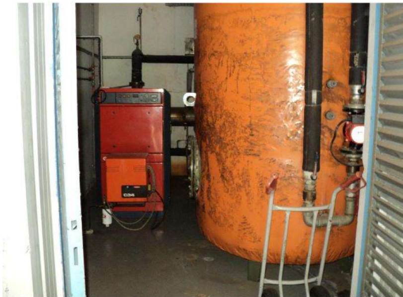
Figure 8 : Chaudière de l'abattoir
