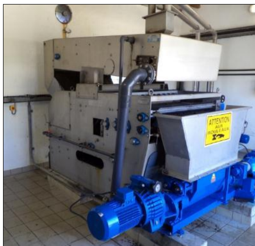
Figure 16 : Unité d'épaississement de la STEP de Yahoué – Source : CDE, 2013
