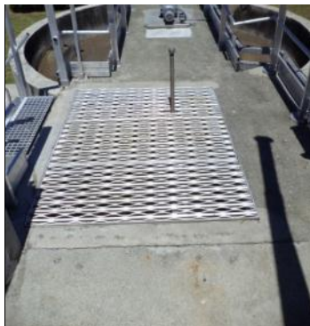
Figure 10 : Ouvrage de répartition de la STEP de Yahoué – Source : CDE, 2013
