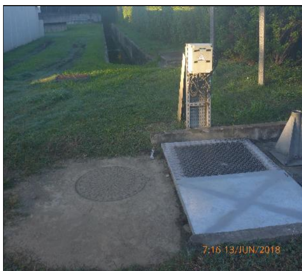
Figure 6 : Poste de relevage de la STEP de Yahoué - Source : EMR, 2018
