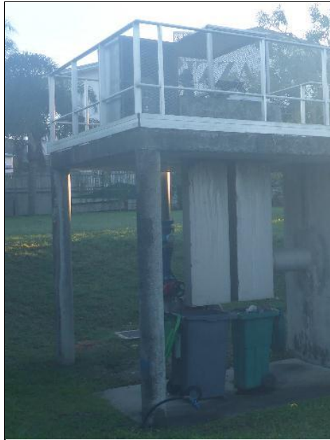
Figure 8 : Dégrilleur de la STEP de Yahoué – Source : EMR, 2018
