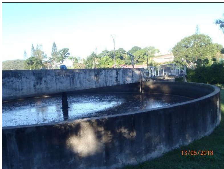
Figure 11 : Bassin d'aération de la STEP de Yahoué -file 3500 EH – Source : EMR, 2018
