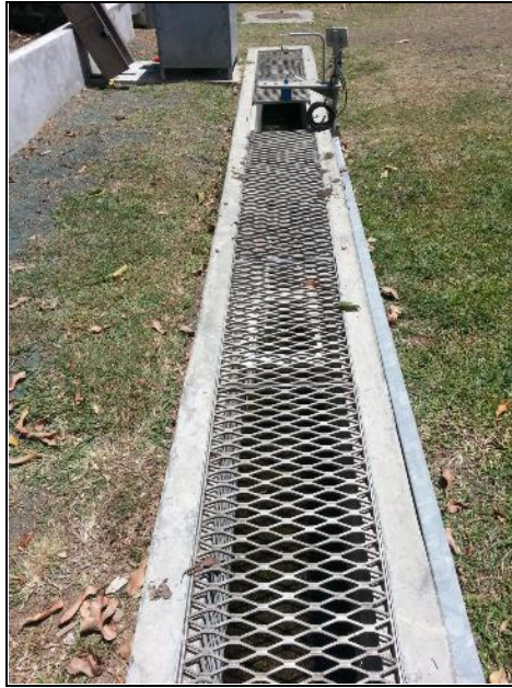
Figure 15 : Canal de sortie pour le comptage des eaux traitées de la STEP de Yahoué – Source : CDE, 2013
