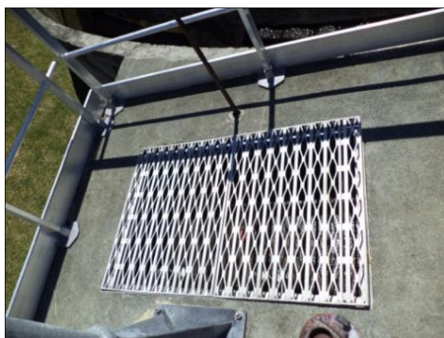
Figure 14 : Puits de recirculation de la STEP de Yahoué – Source : CDE, 2013
