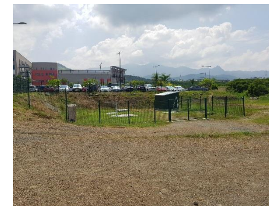
Poste de relevage du centre hospitalier
