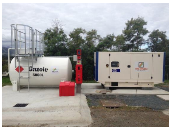
Figure 9 : Groupe électrogène et cuve de gazole.
