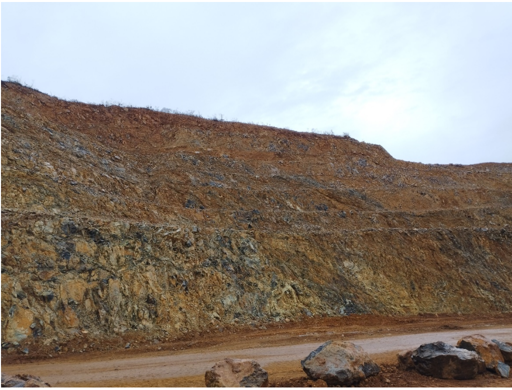
Talus de saprolites rocheuses et péridotites altérées à jeux de structures N90°, N40° et N130
