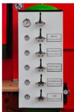
Panneau de commande des pompes
